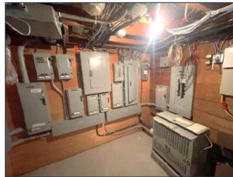
Salle électrique - sous-sol
